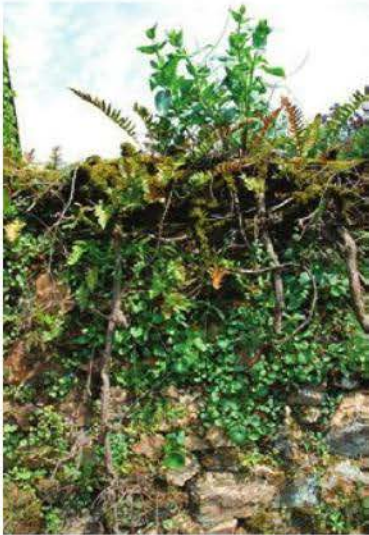
Figure 1 : Mur colonisé naturellement
