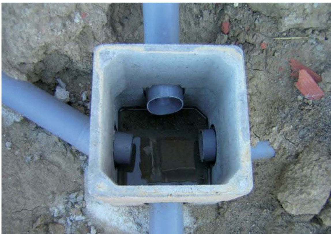
Fig. 7.5 – Collecte des eaux de pluie au regard principal
