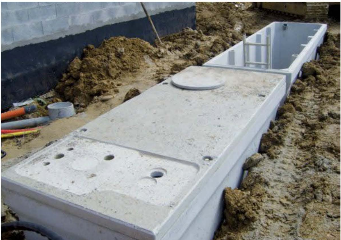
Fig. 2.13 – Stockage de 12 m 3 réalisé en deux cuves de 6 000 L
