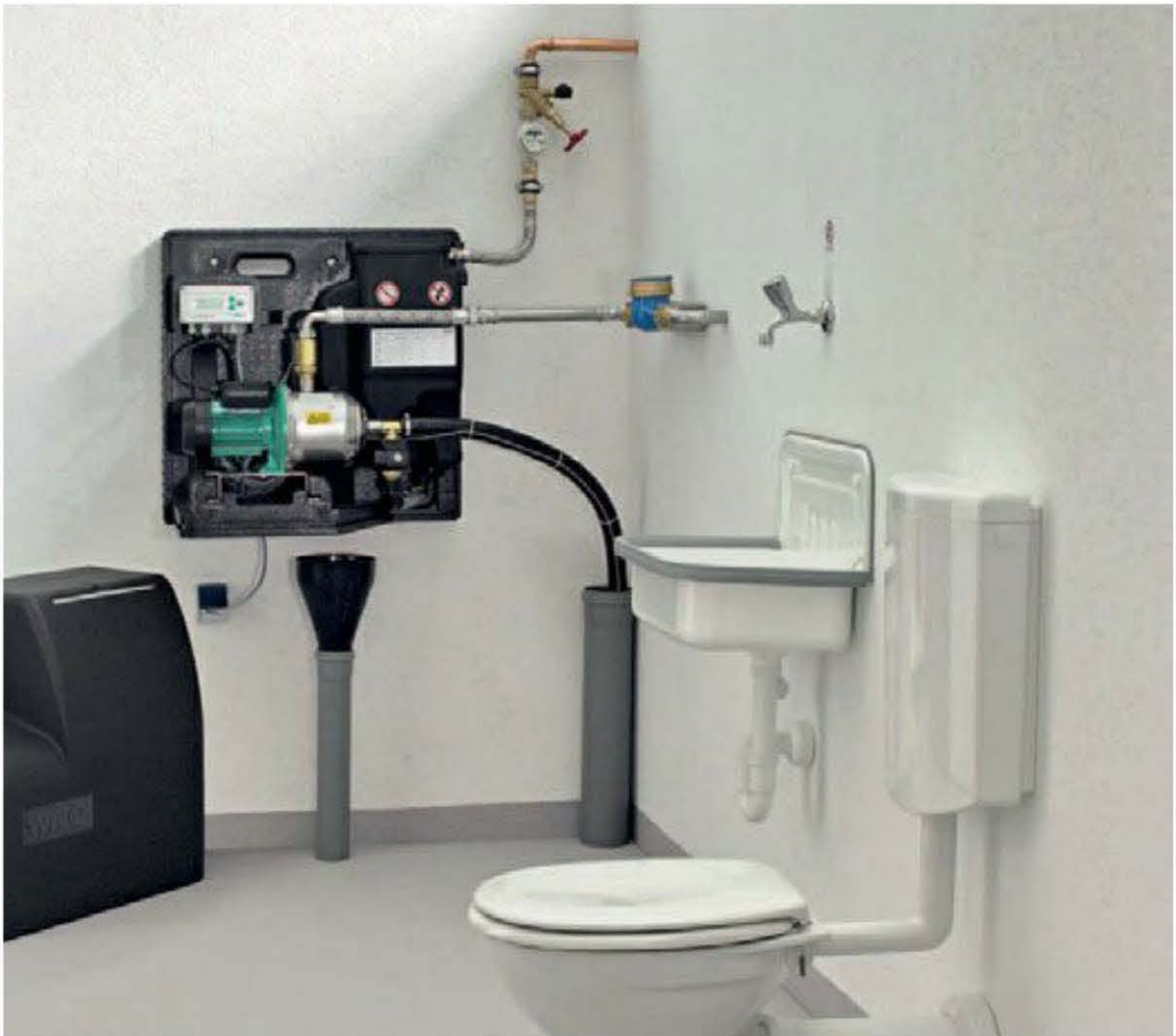
Fig. 4.2 – Installation d'une centrale de gestion dans un local
