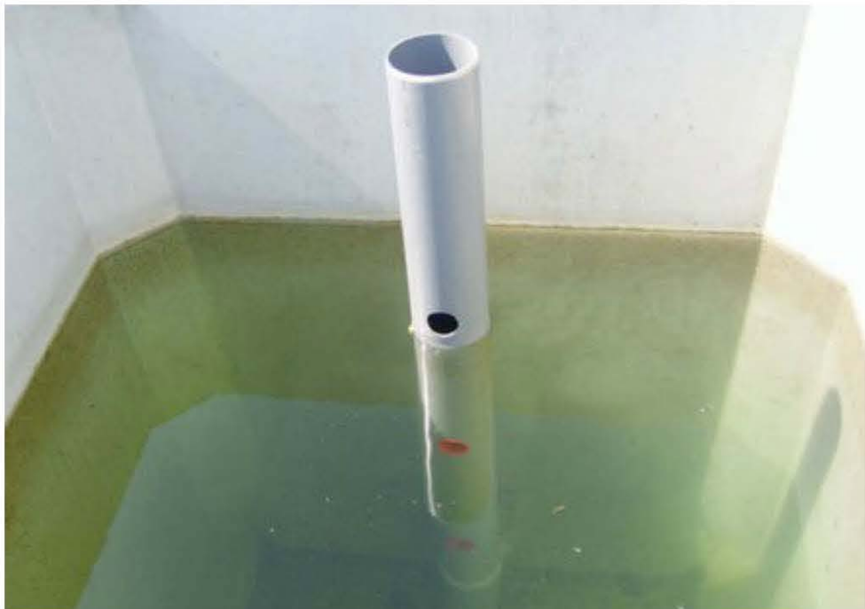
Fig. 7.6 – Cuve de régulation
