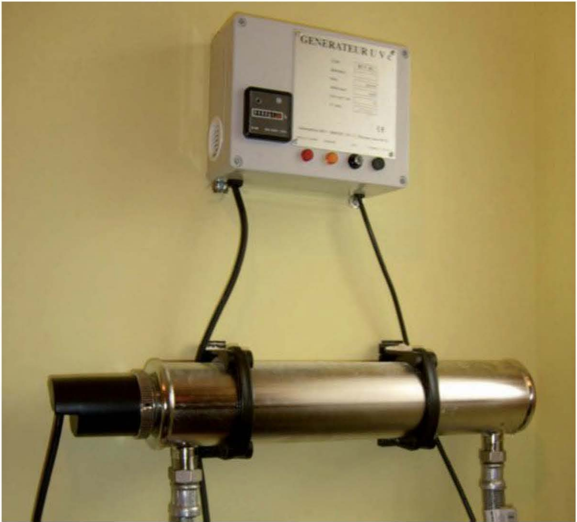
Fig. 6.4 – Installation comprenant un stérilisateur à UVc
