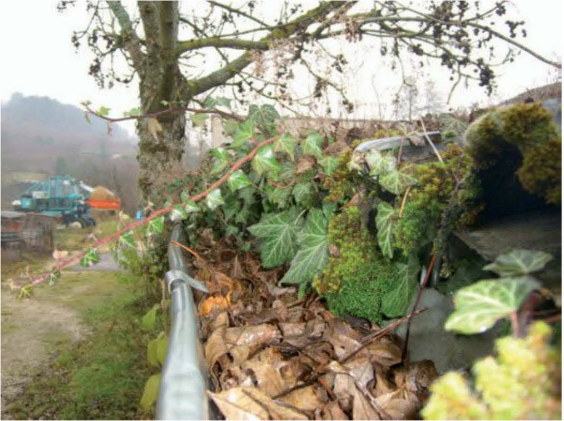
Fig. 3.13 – Gouttière non entretenue
