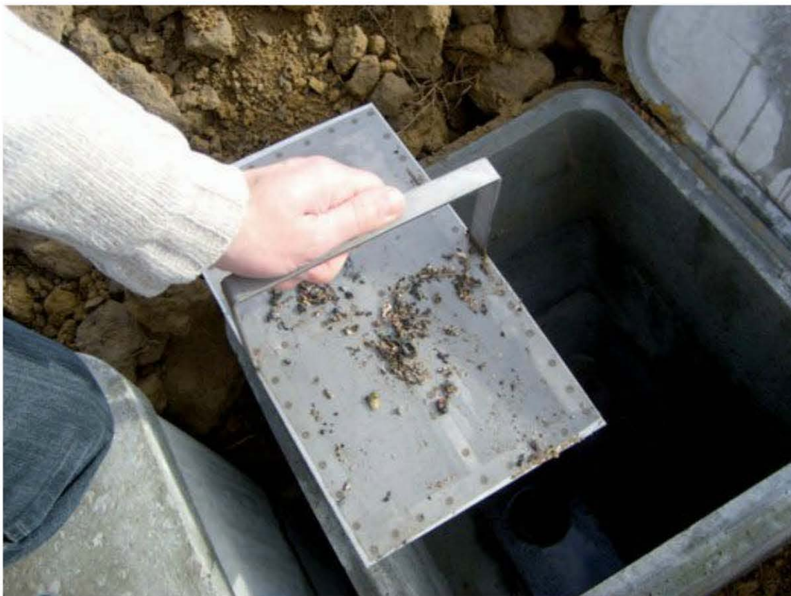
Fig. 3.7 – Préfiltration de l'eau de pluie dans un regard en béton
