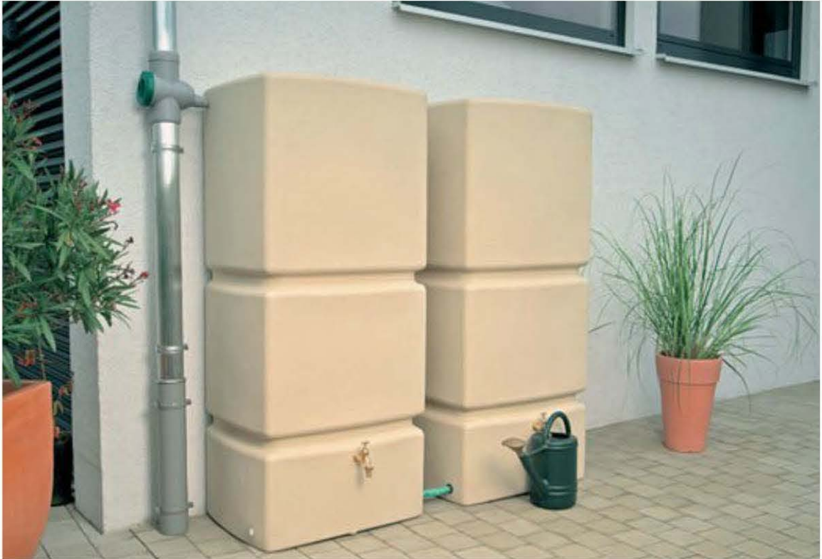
Fig. 2.3 – Récupérateurs d'eau de pluie de 400 L chacun
