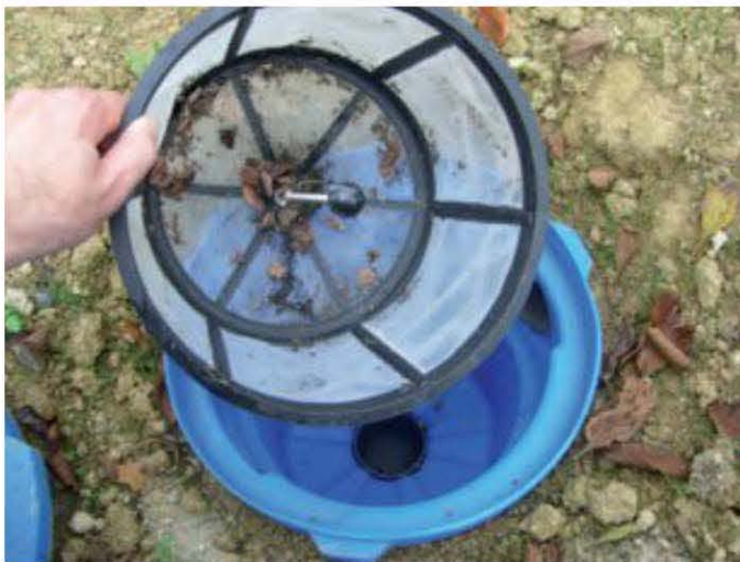
Fig. 3.14 – Nettoyage du préfiltre
