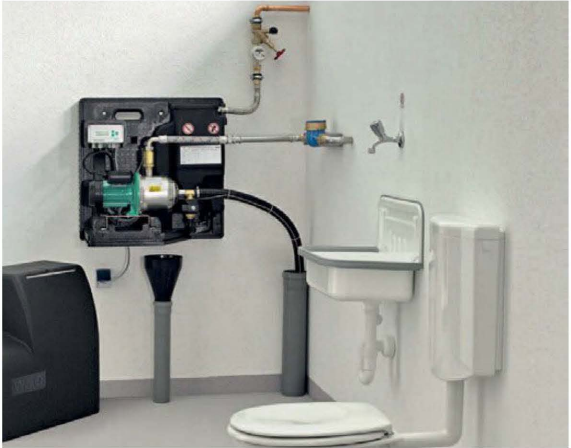
Fig. 1.6 – Alimentation des toilettes en eau de pluie avec un gestionnaire WILO
