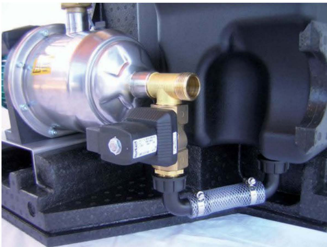
Fig. 4.5 – Vanne 3 voies de la pompe permettant la venue de l'eau de pluie et de l'eau de ville
