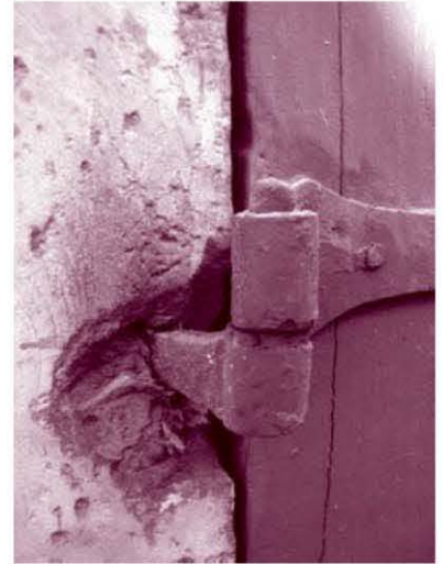
La rouille du gond, directement scellé dans la maçonnerie, a fait éclater la pierre.
