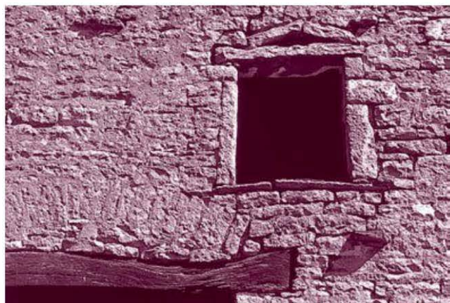
Linteau et appui sont les éléments d'encadrement les plus affectés par les désordres de maçonnerie.
