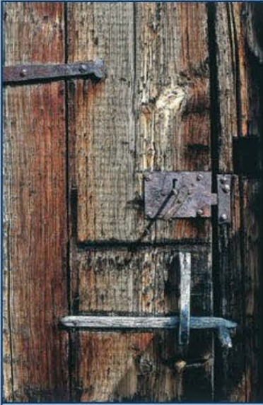
Accessoires d'ouverture en bois et en fer se côtoient sur cette porte de grange. Savoie, Beaufortin (Savoie).
