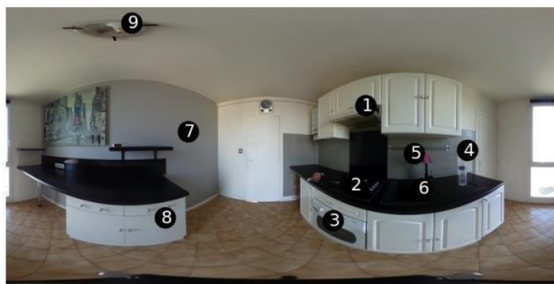
Etat de la pièce : Moyen / Etat de propreté : Nettoyage partiel L'ensemble des prises de courant et des éclairages a été contrôlé (sauf éventuelles mentions ci-dessous).
